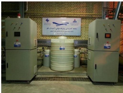
Planta de desinfección de agua industrial Planta de ósmosis inversa - Esfahan Oil Refining Co.- Esfahan -2020 Capacidad: 80 kg FAC/d
