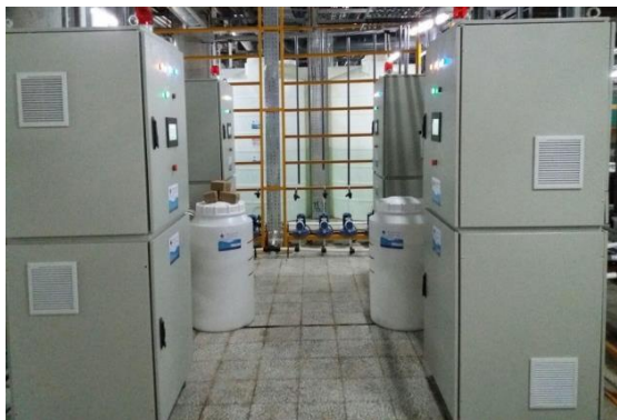
Parque acuático y desinfección del agua de la piscina Parque acuático de Teherán - 2019 Capacidad: 160 kg FAC/d
