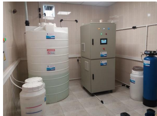
Parque acuático y piscina Desinfección del agua Piscina de la Universidad Médica de Teherán - 2019 Capacidad: 6 kg FAC/d
