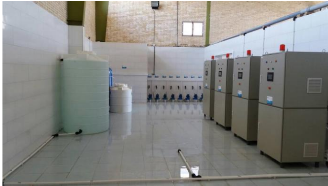
Planta de desinfección de agua potable Shehne-Yazd -2018 Capacidad: 2000 L/s
